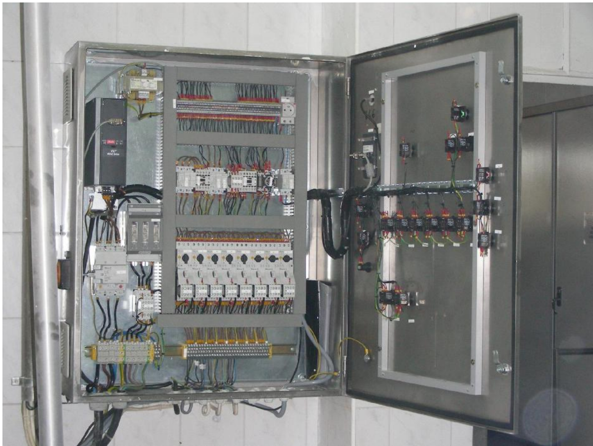
Fot. 3. Wyposażenie obudowy panelu sterowania
